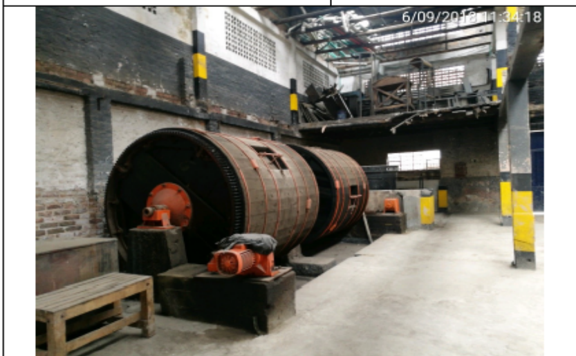
Foto No. 3 Bombos de proceso
